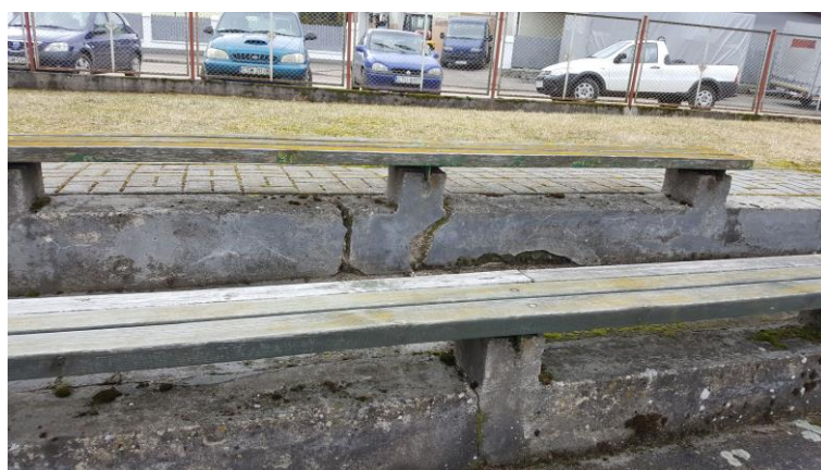
Widoczne uszkodzenia betonowych elementów trybun
