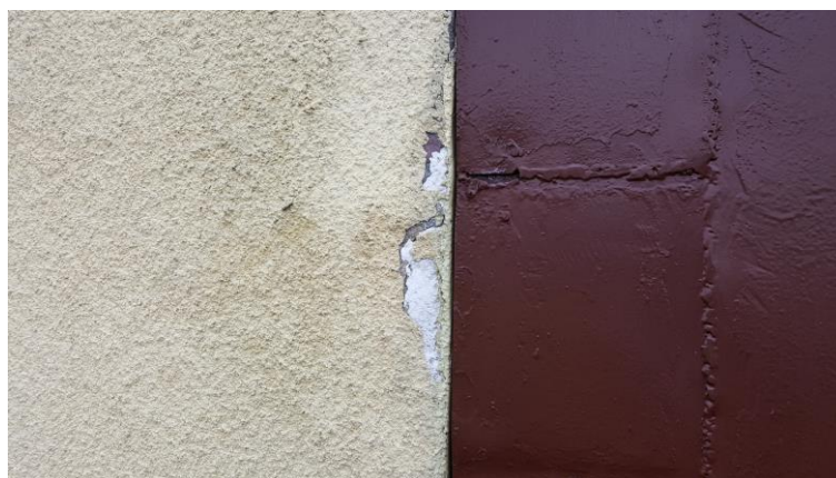
Widoczne uszkodzenia w okolicy stolarki drzwiowej.
