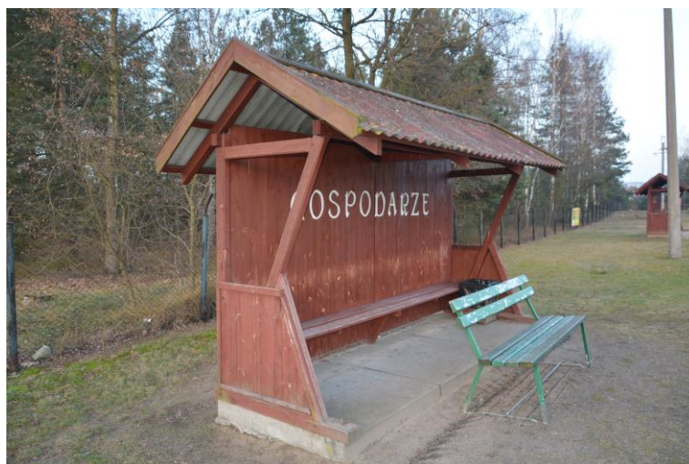
Wiata dla zawodników – korozja biologiczna pokrycia.
