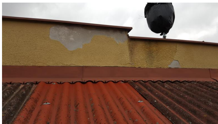
Widoczna korozja , nieuszczelnność pokrycia dachu oraz luźny i odpadający tynk.
