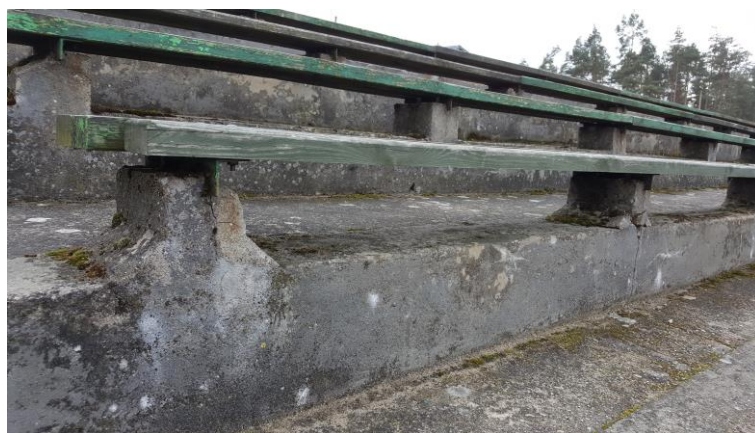
Widoczne uszkodzenia słupków wsporczych siedzisk.
