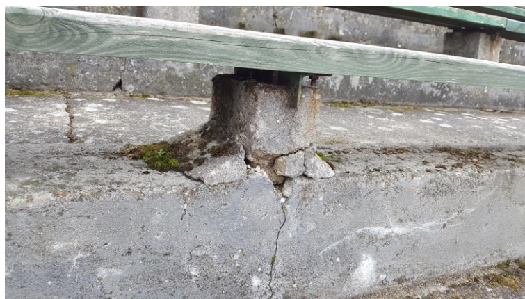
Widoczne uszkodzenia słupków wsporczych siedzisk.
