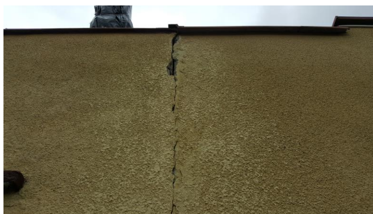
Widoczne pęknięcia w ścianie nośnej.
