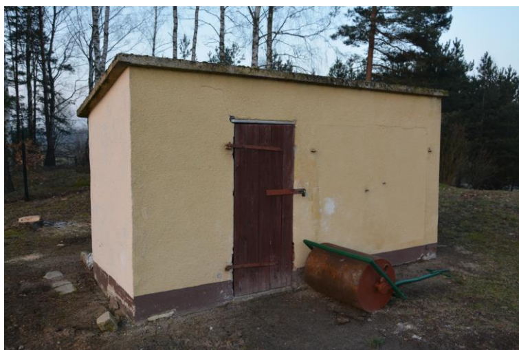
Widoczne uszkodzenia fundamentów, pęknięcia ścian oraz korozja biologiczna płyty żelbetowej i stolarki drzwiowej.
