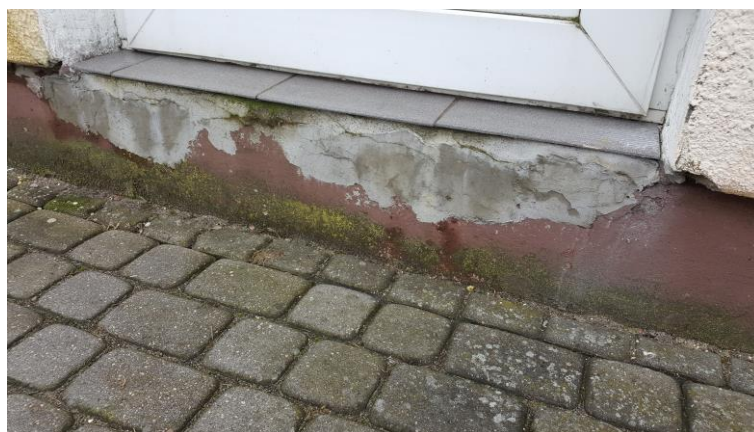
Widoczne pęknięcia w okolicy wejścia do budynku.
