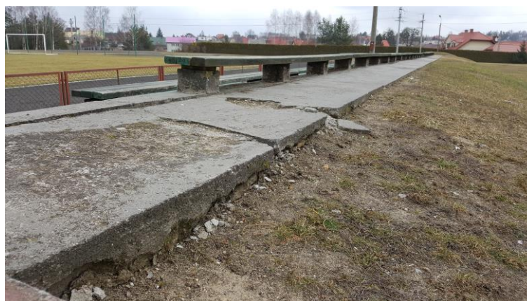
Widoczne uszkodzenia przejść między sektorami.
