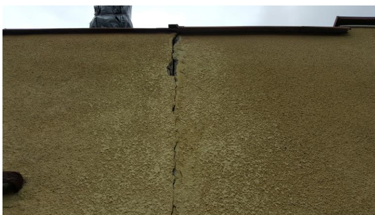
Widoczne pęknięcia w ścianie nośnej.
