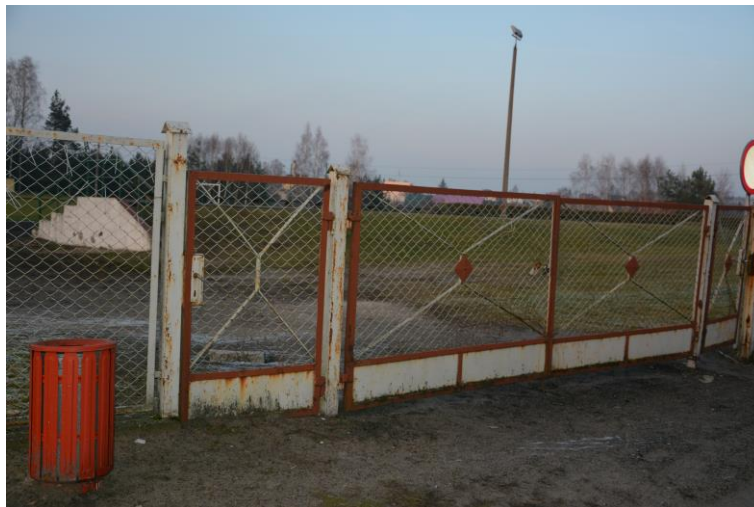
Widoczne ślady korozji oraz liczne uszkodzenia siatki w panelach ogrodzeniowych oraz widok na furtkę z uszkodzonym zamkiem.
