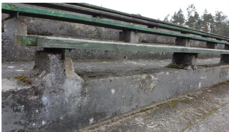
Widoczne uszkodzenia słupków wsporczych siedzisk.
