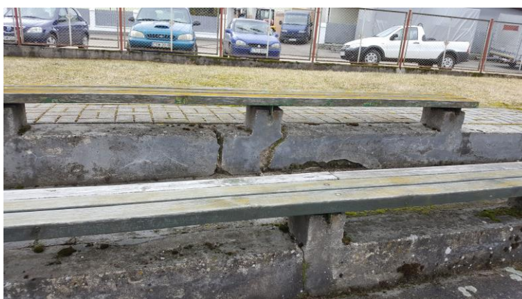
Widoczne uszkodzenia betonowych elementów trybun
