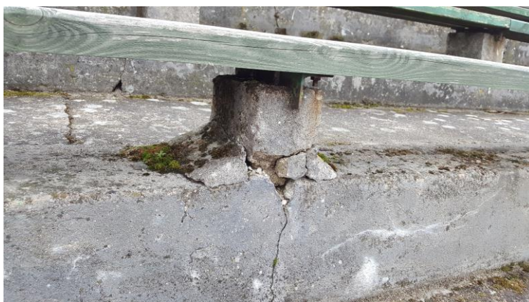
Widoczne uszkodzenia słupków wsporczych siedzisk.
