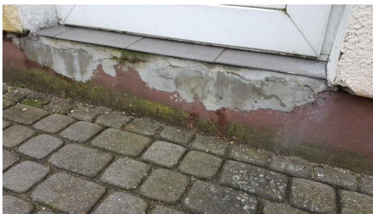
Widoczne pęknięcia w okolicy wejścia do budynku.
