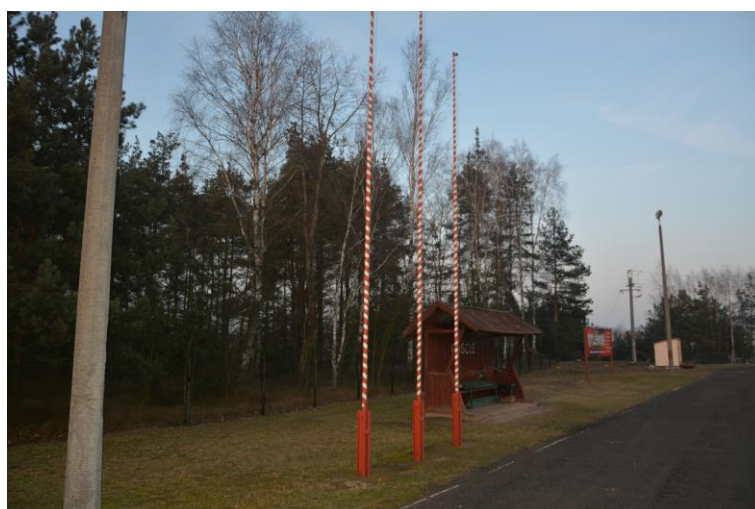
Wiata dla zawodników – uszkodzenia betonowego podestu oraz korozja biologiczna siedziska.
