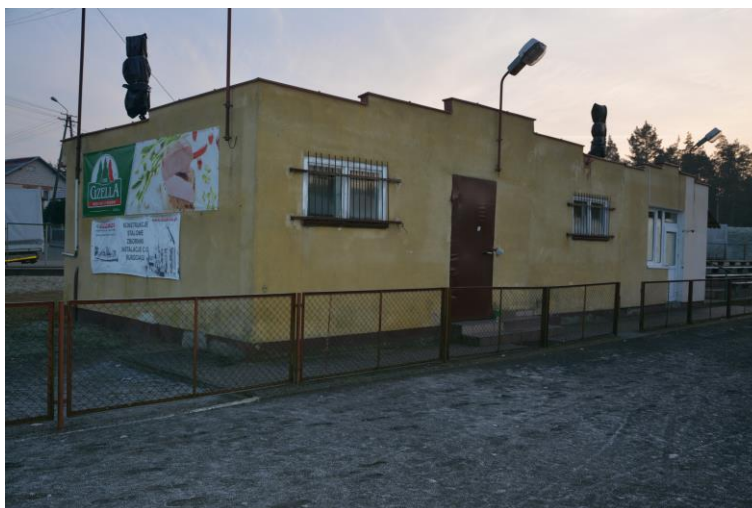
Budynek szatniowo- sanitarny – widoczna korozja biologiczna stolarki okiennej i drzwiowej oraz konstrukcji wsporczych na budynku
