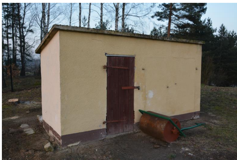
Widoczne uszkodzenia fundamentów, pęknięcia ścian oraz korozja biologiczna płyty żelbetowej i stolarki drzwiowej.
