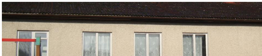
Elewacja tylna – widoczne ślady korozji biologicznej pokrycia oraz miejscowe nieszczelności.
