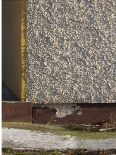
Elewacja tylna, elewacja boczna prawa – miejscami odpadający tynk.
