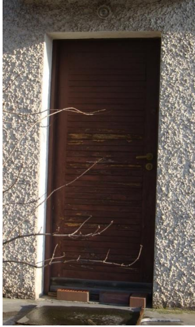
Elewacja boczna prawa – stolarka drzewiowa z widocznymi oznakami wypaczenia.
