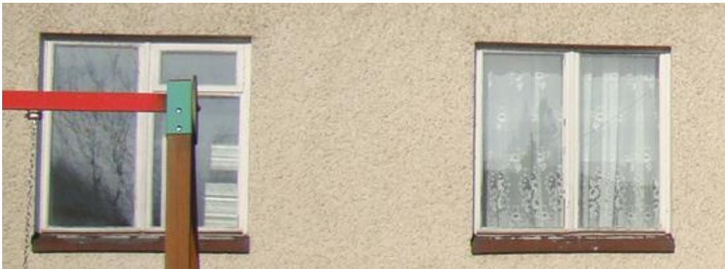
Elewacja tylna – widoczne ślady korozji biologicznej stolarki okiennej oraz miejscowe pęknięcie oszklenia oraz odpadająca farba na parapetach
